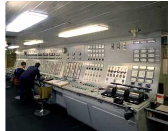
In der Kommandozone des Maschinenraums: Von hier aus wird jede Funktion des Schiffes überwacht.
